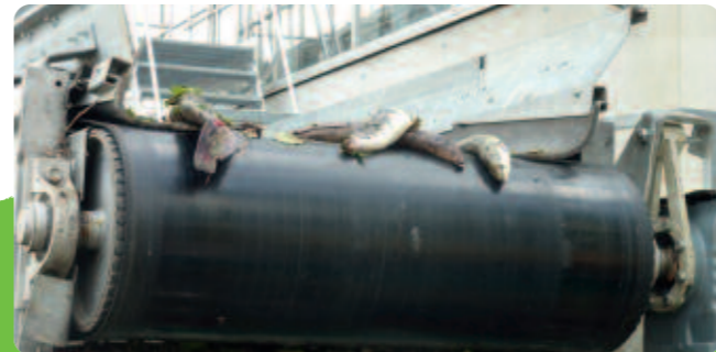
Im Wasserkraftwerk Kostheim getötete Fische
